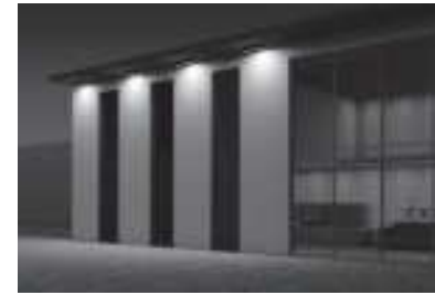
Die Installation der Fassadenscheinwerfer kann sowohl an Boden- als auch an Deckenflächen erfolgen.
